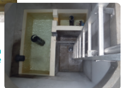
installation bien entretenue
