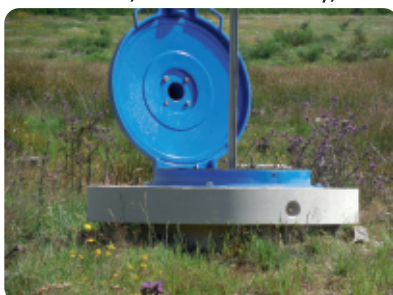
Regard de captage
