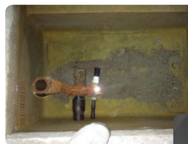
Nettoyage de l'installation à prévoir rapidement
